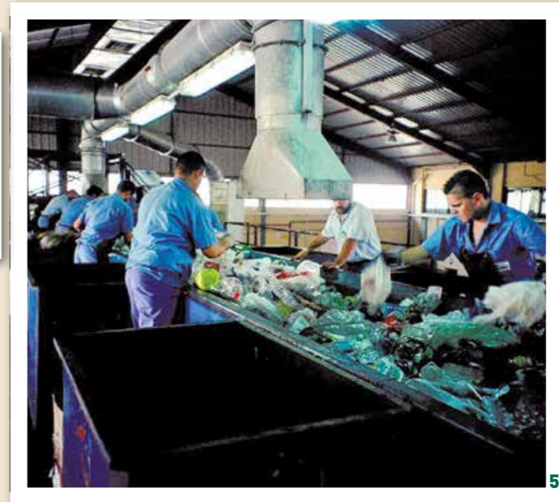
5. Aspiración semiautomática en cabina de triaje secundario.
