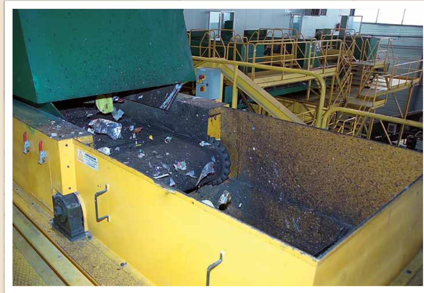
1. Separador de Inducción.
